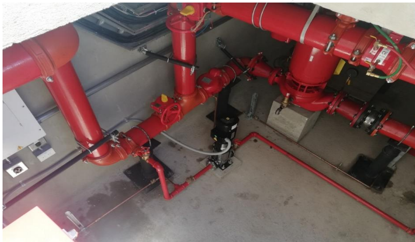
Imagen 8. Ítem 23.3 Sistema equipo contraincendios.
