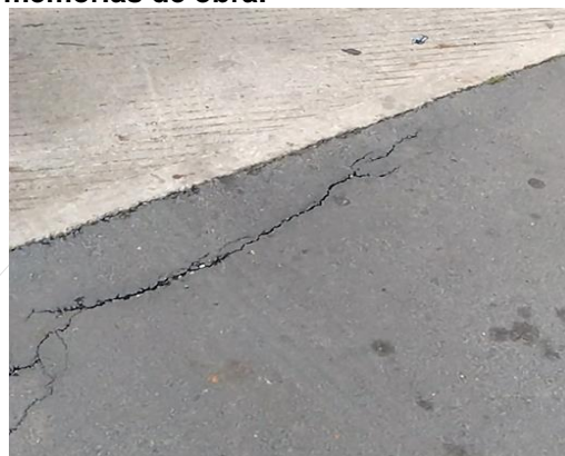
Imagen 40. Junta agrietada entre pavimento flexible y pavimento rígido.
