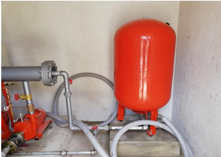
Imagen 2. Ítem 23.2: Tanque Hidroacumulador de 500 LTS y elementos necesarios para su funcionamiento
