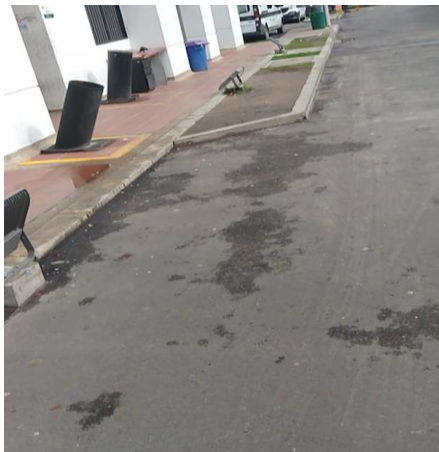
Imagen 35. Fallas generalizadas en la carpeta asfáltica acceso principal
