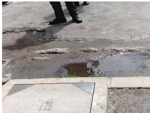
Imagen 38. Zona del parqueadero donde se debió aplicar carpeta asfáltica, según memorias de obra.
