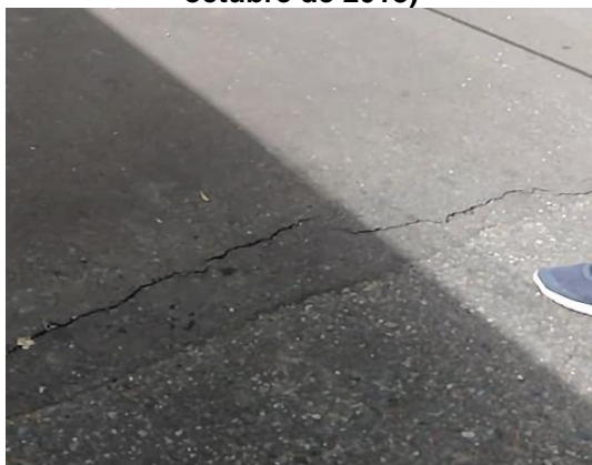
Imagen 39. Junta agrietada entre pavimento flexible nuevo y antiguo.
