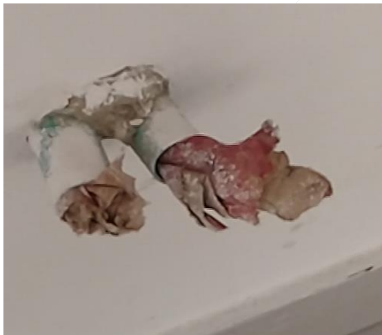
Imagen 21. Salida eléctrica sin sellar
