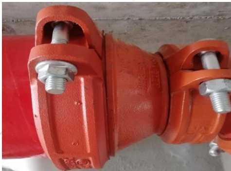
Imagen 18. Ítem NP-136. Tubería acero carbon schedule 40 6 "
