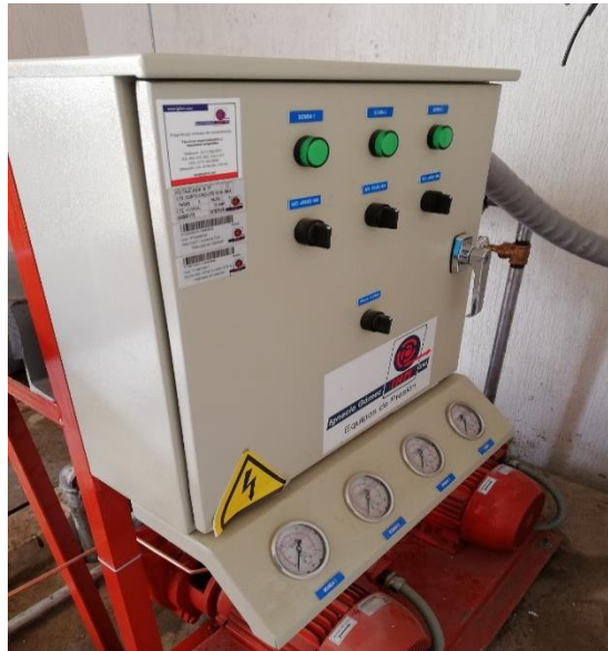
Imagen 3. Ítem 23.2: Tablero de control de Bombas.
