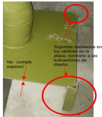
Imagen 30. Placa anti vórtice instalada, sin cumplir especificaciones.
