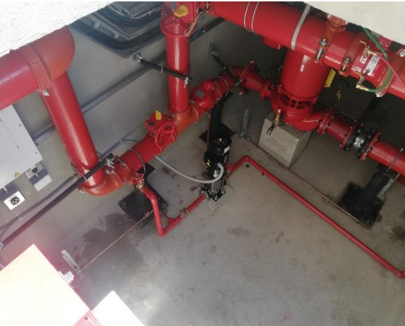
Imagen 16. Ítem NP-134. Tubería acero carbon schedule 40 6 "
