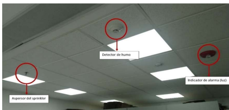
Fotografía 74 Sistema contraincendios automático
