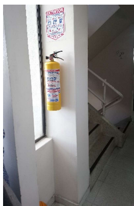
Fotografía 77 Extintor en zona común
