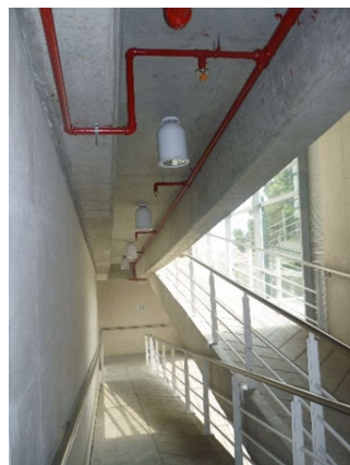
Fotografía 100 Sistema de extinción automática de incendio tipo Sprinkler
