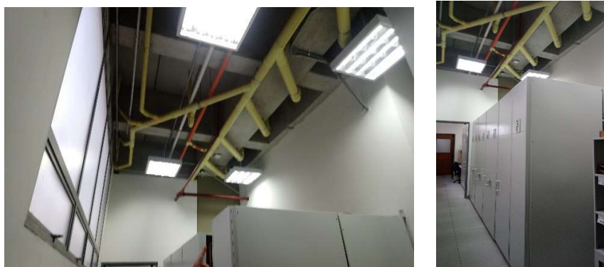
Fotografía 105 Tubería descubierta en el techo sobre la estantería
