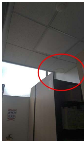
Fotografía 103 Manchas de humedad en el techo
